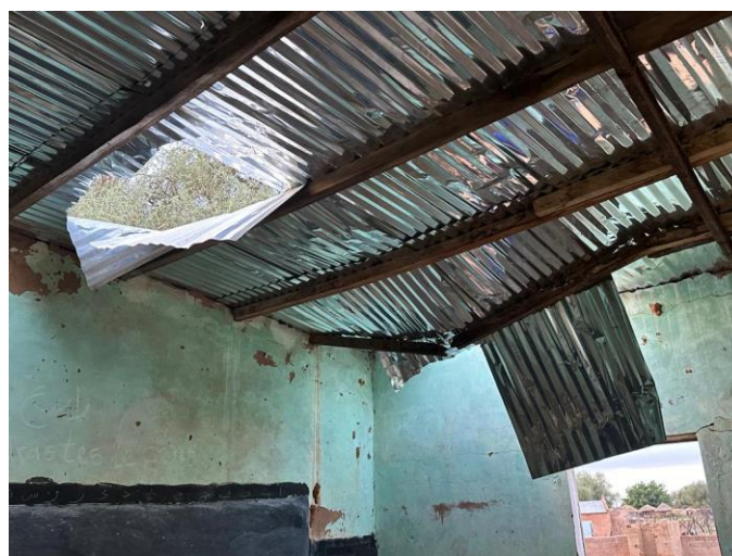
La toiture de l'Ecole en très mauvais état
